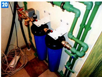
20 Установленные фильтры тонкой очистки не сложно поменять при необходимости.
