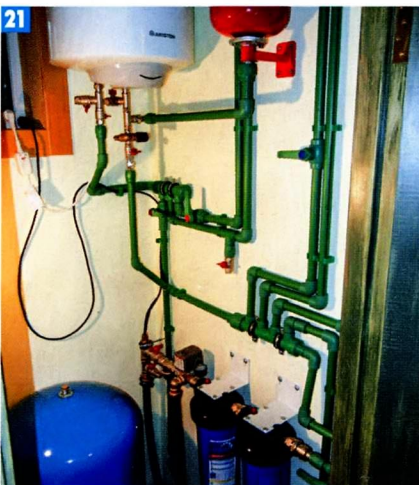
21 Коллекторная система водопровода с водонагревателем и фильтрами для воды.
