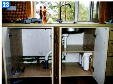
23 Вентили для слива воды из трубопроводов расположены и на кухне под мойкой.
