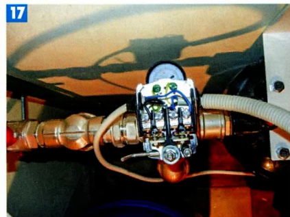
17 Электромеханическое реле давления встроили в основную магистраль.
